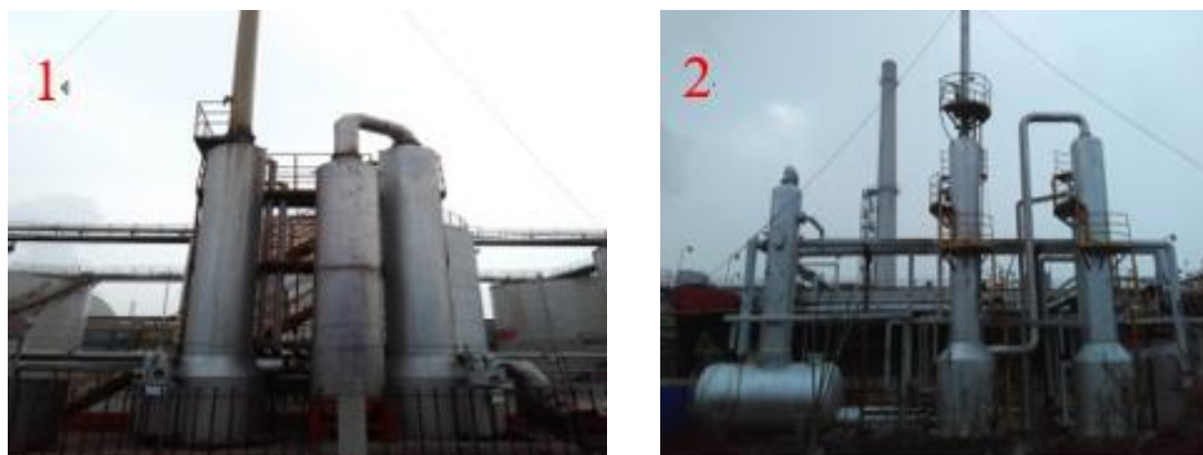
图 27 焦化厂 VOC 治理装置
